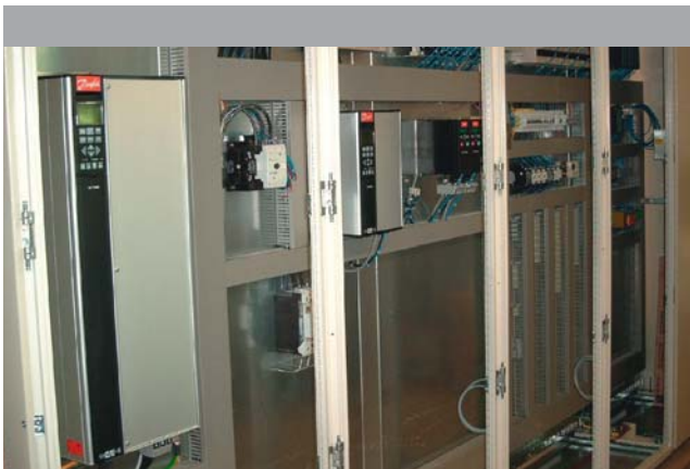
Last- und Steuerschrank Extruder – Load and control cabinet for extruder
