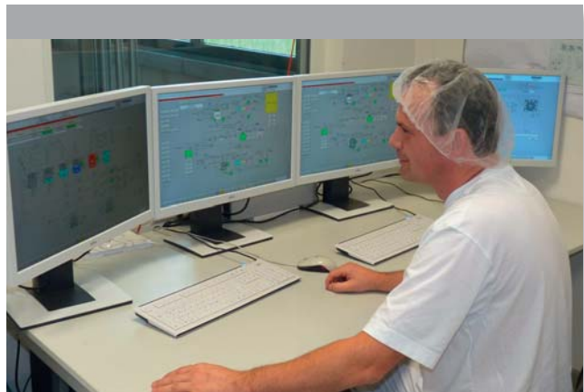
Visualisierungs-PCs in einer Schaltwarte – Visualisation PCs in a control room
